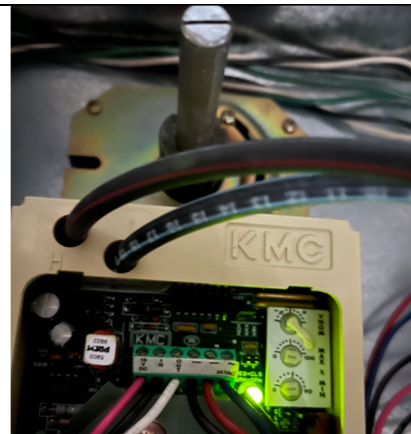
6. Malfunctioned VAV actuator
